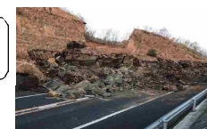
常磐自動車道の被災状況
