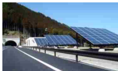
道路空間の太陽光発電設備
