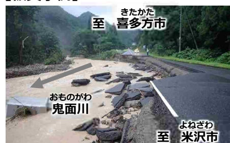
国道121号 令和4年8月の大雨
